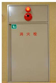
おくないしょうかせん 屋内消火栓
