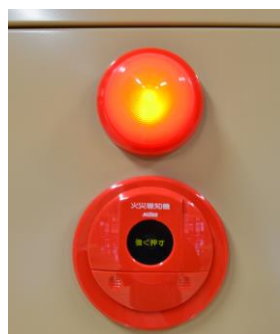
かさいほうちき 火災報知器
