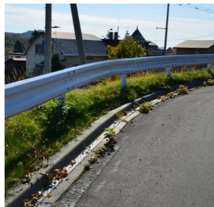
ガードレール
