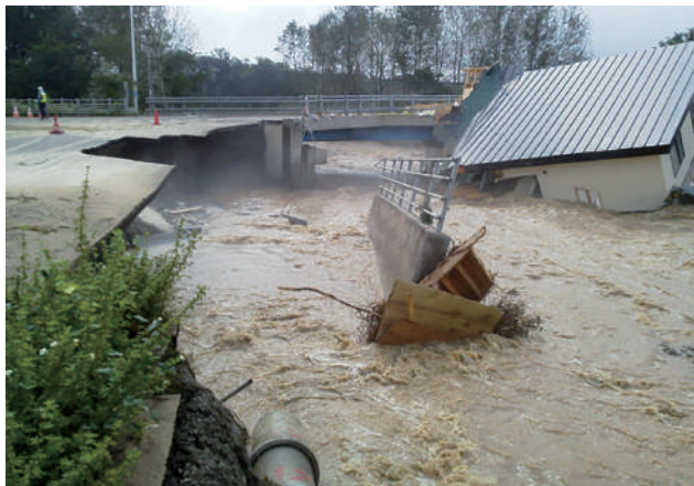
橋の被災 ひさい (新得町 しんとくちょう )
