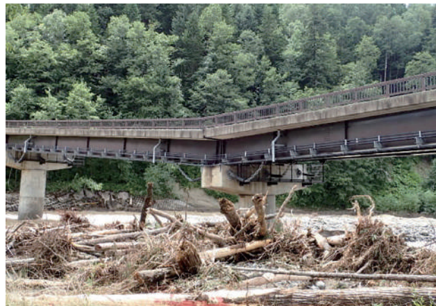
橋脚の沈下 きょうきゃく (上川町 かみかわちょう )
