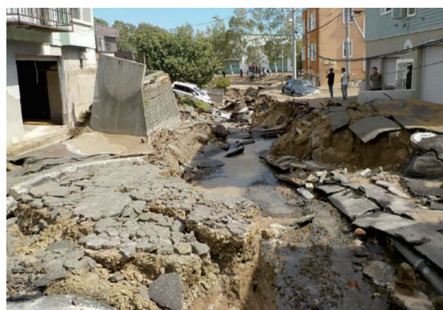
液状化被害 (札幌市・清田区)
