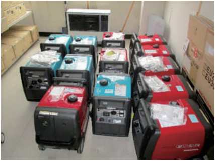
非常用発電機
